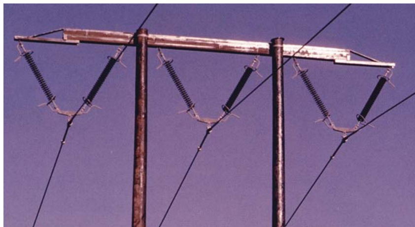
slika 2. Nadzemni vod sa izolovanim AIFe užetom u Norveškoj ( naponski nivo 145 kV )
