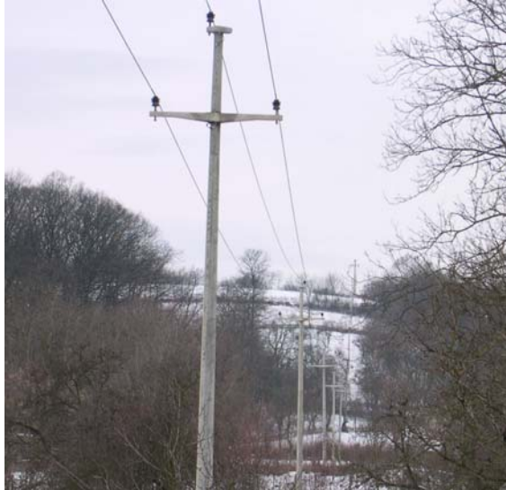
slika 7. Nadzemni 10 kV vod »KRAVLJI DO – ŠLJIVOVAC« sa izolovanim užetom na teritoriji J.P.ELEKTROMORAVA Požarevac
